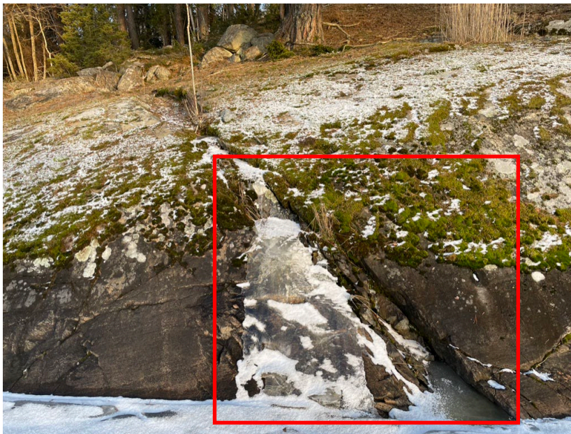
Figur 11. Vattenförande spricka i det i övrigt täta berget som här är täckt av grön mossa och svart okänd påväxt. Vattnet som följer sprickan rinner ut över berghällen och fryser till is under vinter med köldgrader och i bild markeras isen med en röd ruta. Långsjön, Rimbo. Foto N. Rantakokko 2023.
